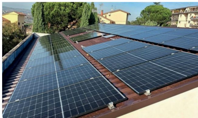
Impianto Industriale 30,34 kWp su tetto a falda, Benevento (BN)
