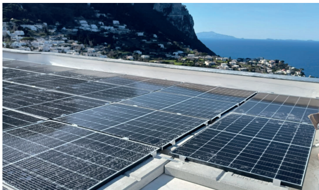
Impianto Industriale 18,5 kWp con sistema Sun Ballast, Capri (NA)
