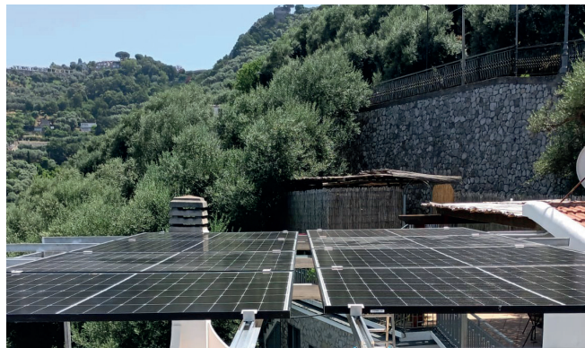
Impianto Domestico 3,2 kWp con accumulo da 4,8 kWh su struttura in ferro zincato, Massa Lubrense (NA)
