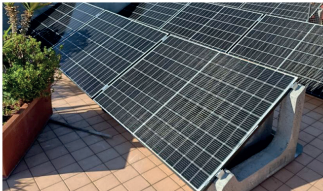
Impianto Domestico 3,2 kWp con sistema Sun Ballast, Napoli (NA)
